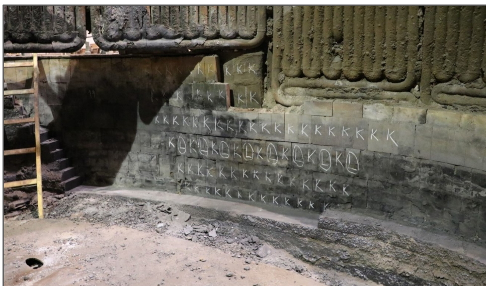
Obr. 6 Pohľad na trvalú výmurovku EAF s tvarovkami KAMAG 92 a SLI 95 po ukončení 256-tavbovej kampane
