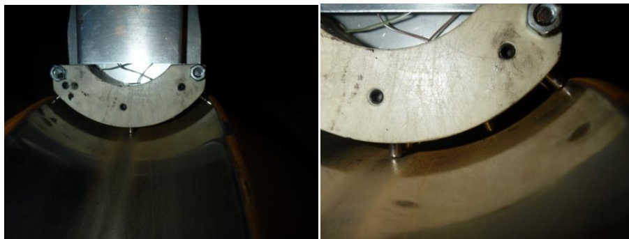
Obr. 12 Termočlánky na valcoch stojana redukovne
